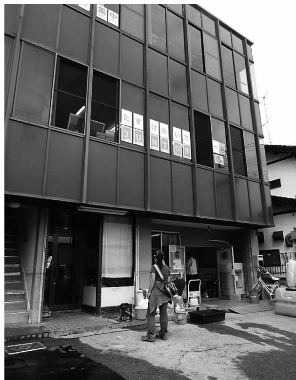
茨城NPOセンター事務所も1階部分が水に浸かった
